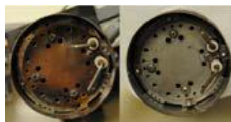
Ejemplo de no funcionamiento y quemadores en funcionamiento.
